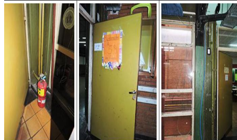
Extintores en lugares de difícil acceso, sin colgar con su correspondiente señalética
